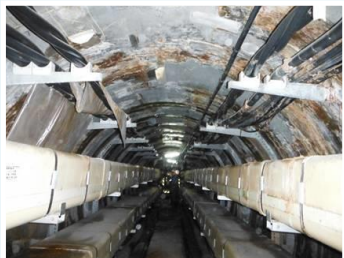
▲洞道内の劣化事例
