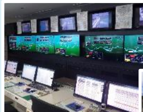
▲放流操作（制御室）
